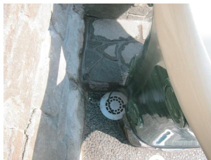
写真3 落ち葉などのゴミを直接外部に流せる排水口
